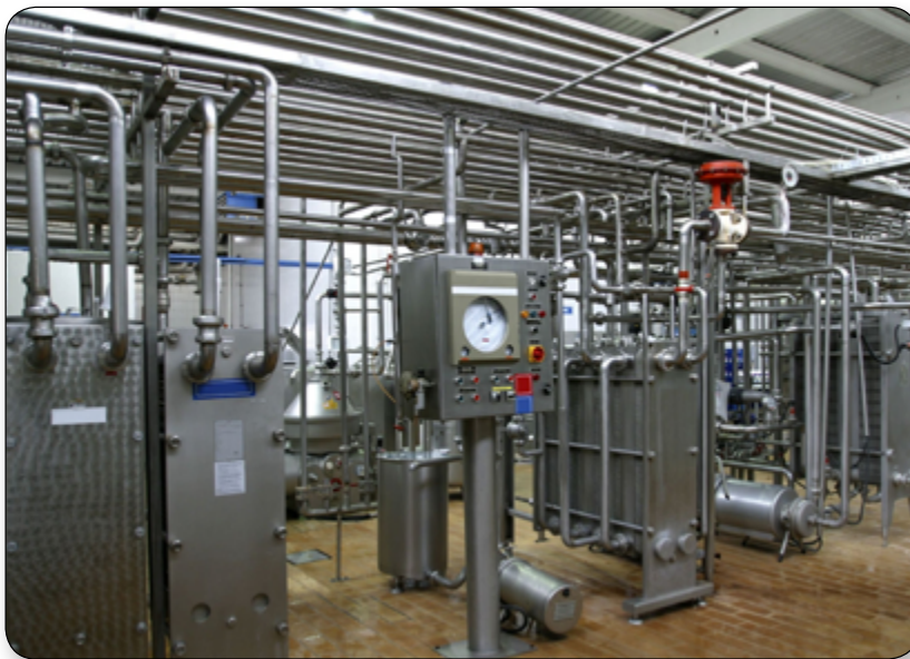
Obr. 3 Příklad strojní části technologického interface v mlékárenském provozu.
